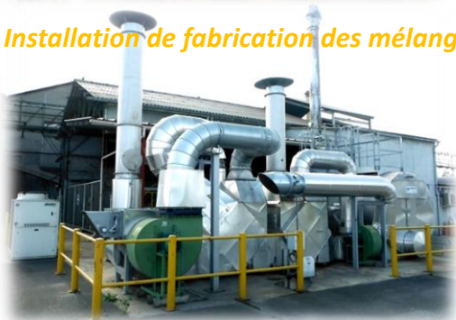
Traitement des gaz
